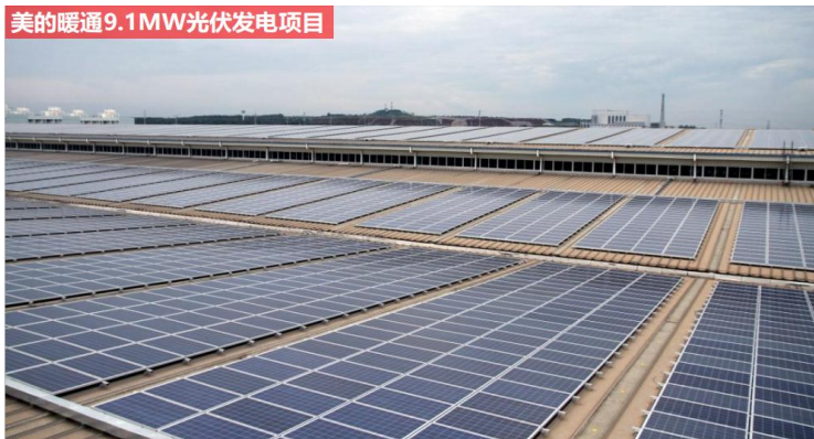
中国首个分布式光伏发电应用示范区并网项目——惠而浦中国2.64MW光伏电站项目
